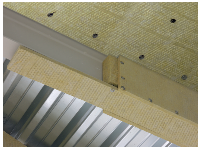
Tre siders brannsikring av en stålbjelke i kombinasjon med brannsikring av et trapesformet stålplatetak.
